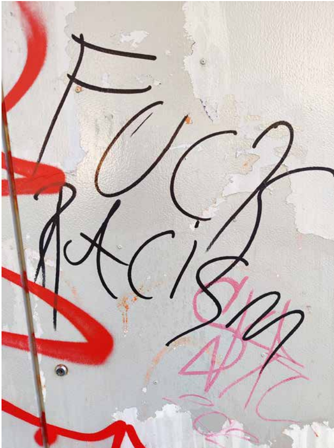
Kuva 1. Antirasistinen viesti sähkökaapissa.
